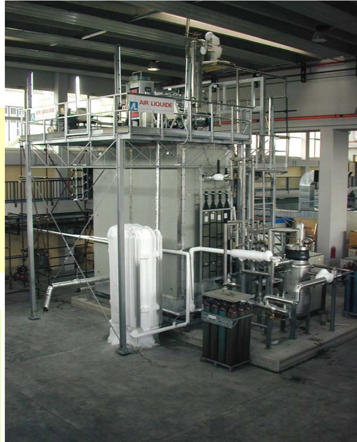
T15 installation @ LNGS (Hall di Montaggio)
